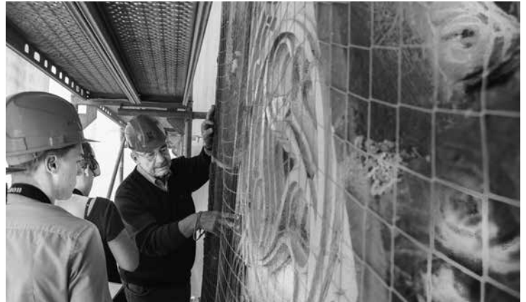
Architekt Günter Hornfeck (rechts) zeigt einigen Pressevertretern die Schäden an der Fassade der Michaeliskirche.
